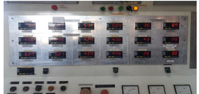
Ilustración 2. Panel de control de la planta continua (sulfonación)
